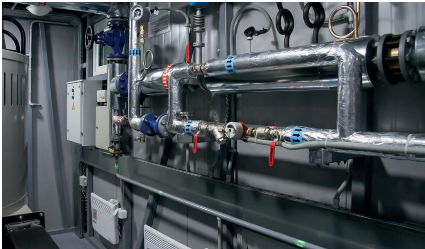
Узел ввода исходной воды в котельной из водопровода
