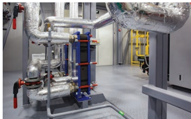
Теплообменники (раб./рез.) контура ГВС
