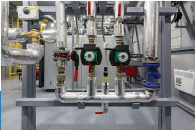
Блок циркуляционных насосов 1-го контура ГВС
