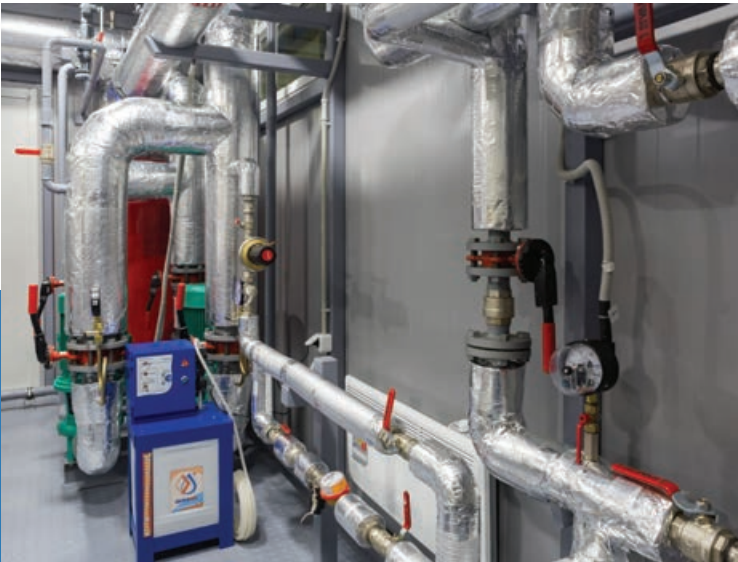
Дозирующий комплекс на подаче ГВС потребителю
