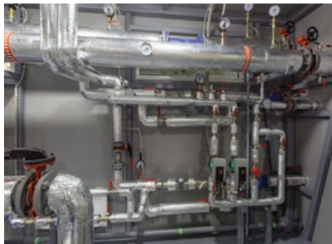
Узел ввода общекотельных трубопроводов
