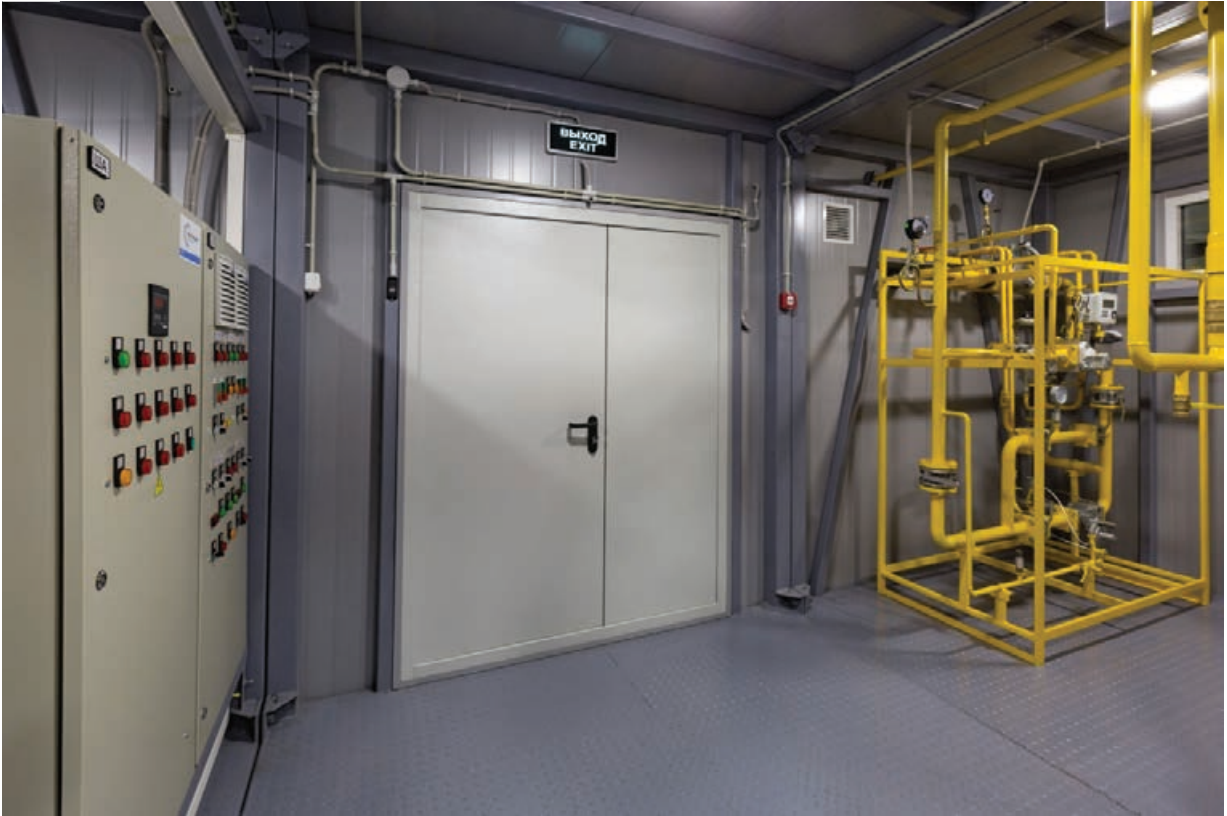
Вход в котельную: двери противопожарные с возможностью открытия второй створки
