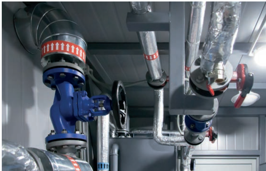
Блок инженерных коммуникаций паровой котельной
