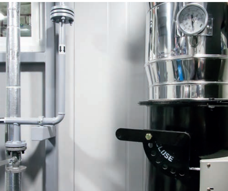
Газоход котла Booster BSS 1500 SD
