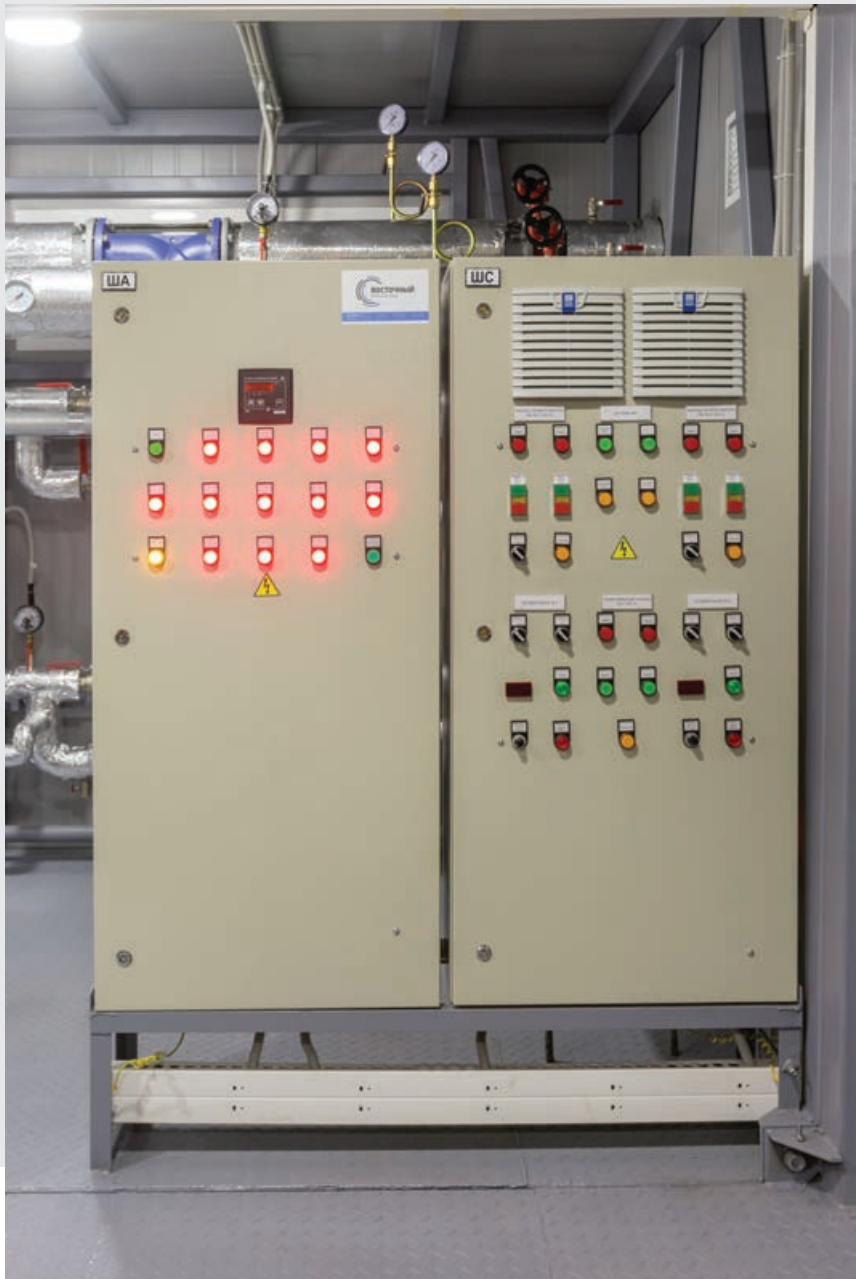
Общий вид: шкаф автоматики котельной, шкаф силовой
