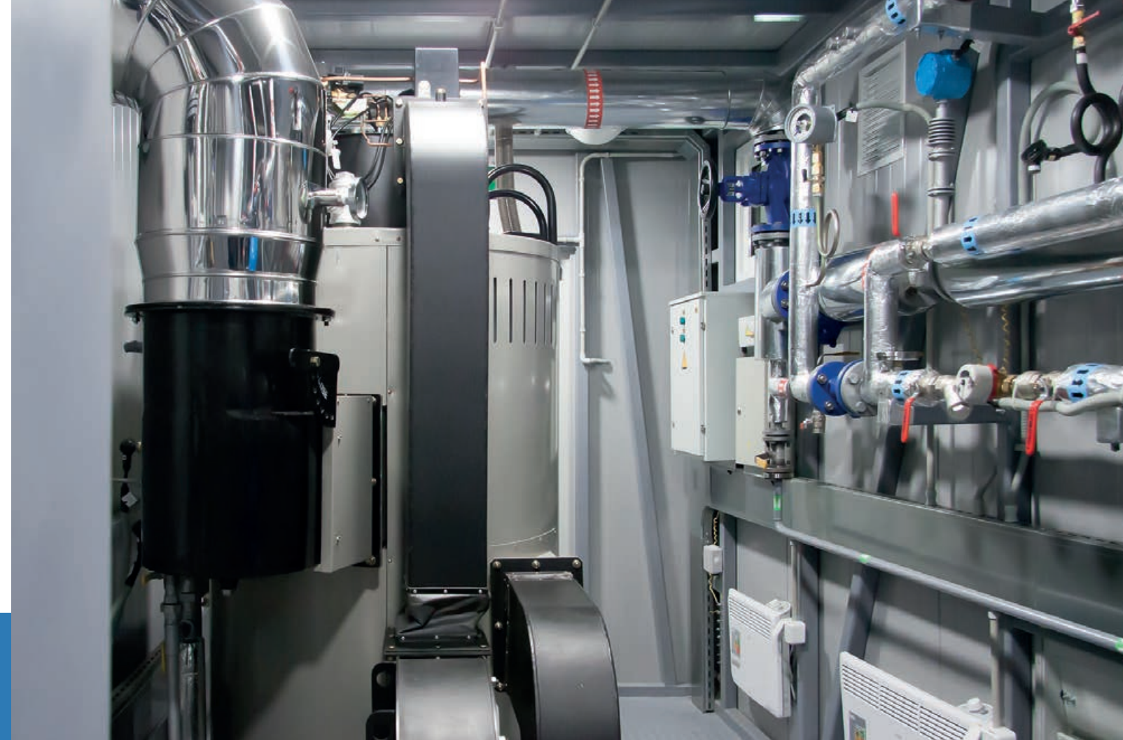
Газоход котла Booster BSS 1500 SD (слева) Водомерный узел (справа)
