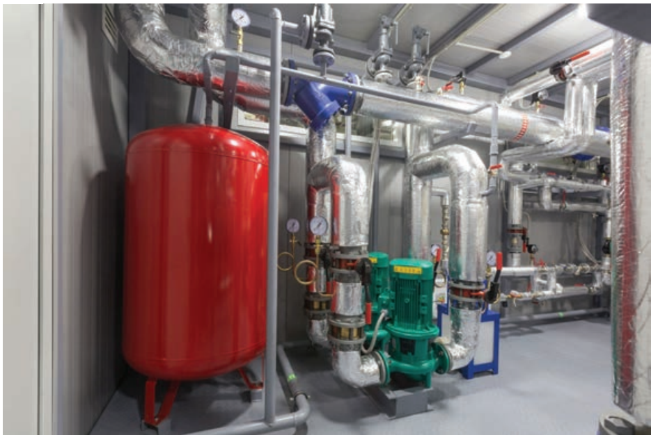
Блок сетевых насосов (раб./рез.) контура отопления
