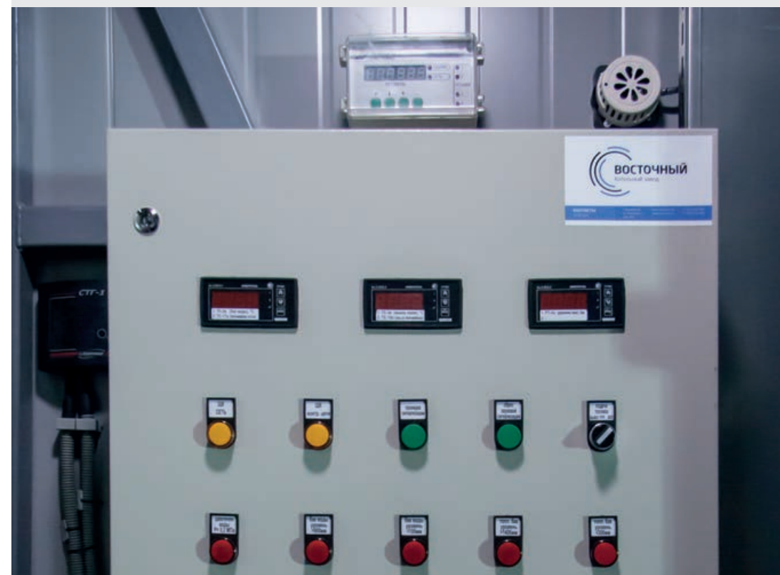
Щит аварийной сигнализации котельной
